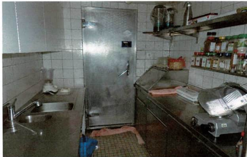
Gardemanger, Kühlzelle Gebäude Nr. 136
