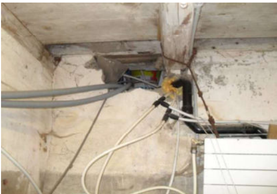
Leitungen in Waschküche
