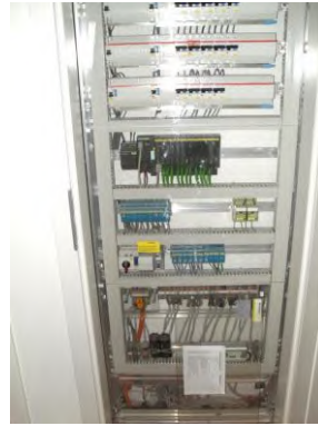
Elektroverteilung im OG
