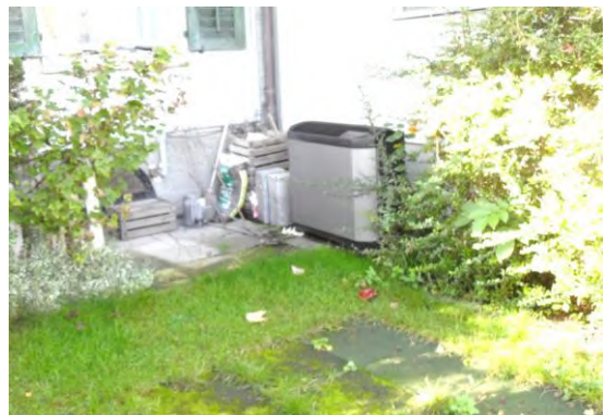
Wärmepumpe zu Schwimmbecken
