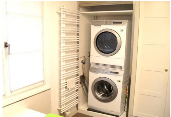
Wasch- und Trocknungsautomat (im Bad)
