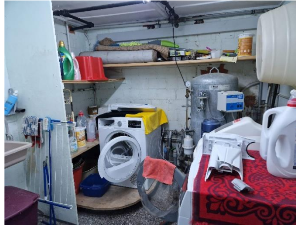
Waschküche mit Frischwasserpumpe
